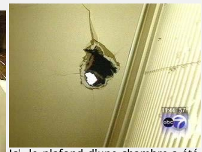
Ici, le plafond d'une chambre a été traversé par une pierre de 500
